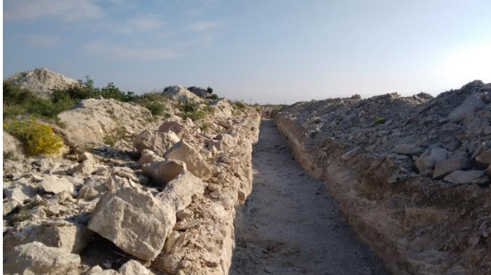
ILUSTRACIÓN 1.- TRABAJOS SUSPENDIDOS EN LO QUE SERÁ EL LIENZO CHARRO MUNICIPAL.
